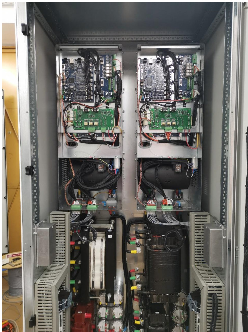
Sl. 2.1. Fotografija unutrašnjosti razvodnog ormara s oba PWM usmjerivača snage 100 kVA i pripadajućim LCL filtrima ispod njih
