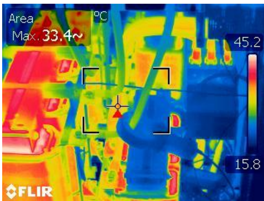
Sl. 4.7 Termografska slika dijela LCL filtera koji obuhvaća pretvaračku prigušnicu
