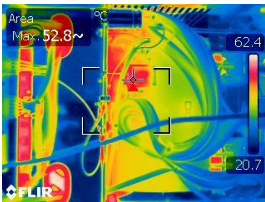
Sl. 2.6 Termografska slika dijela LCL filtera koji obuhvaća pretvaračku prigušnicu
