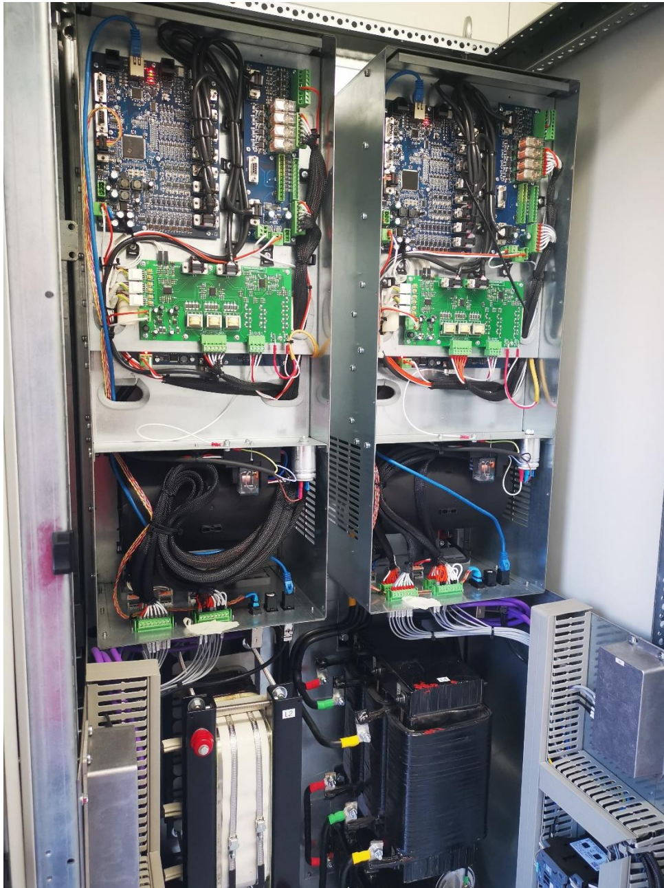
Sl. 2.1. Fotografija unutrašnjosti razvodnog ormara s oba PWM usmjerivača snage 100 kVA i pripadajućim LCL filterima ispod njih
