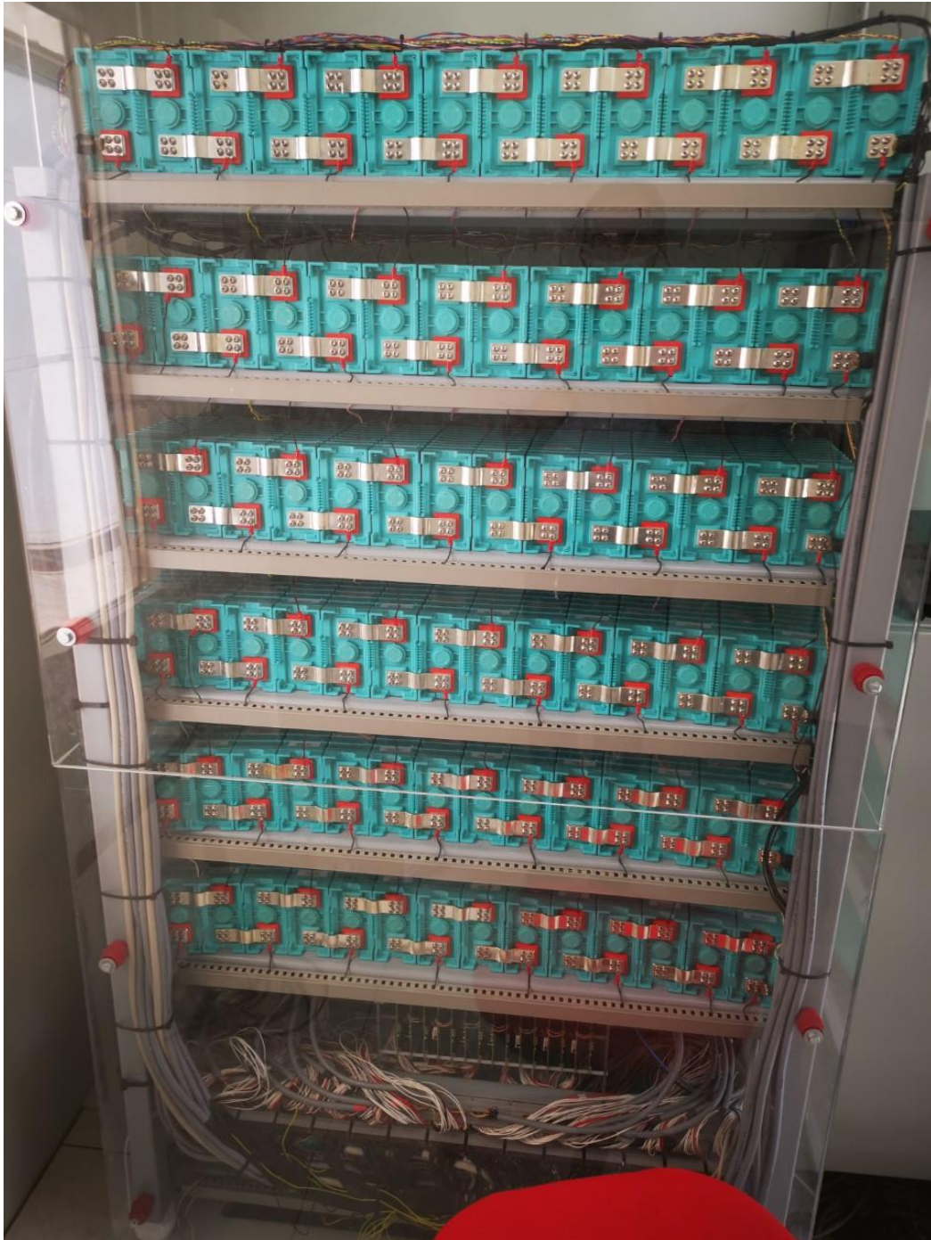
Sl. 1.2 Prvi niz litij-ionskih baterija kapaciteta 100 Ah s pripadajućim BMS sustavom ispod baterija
