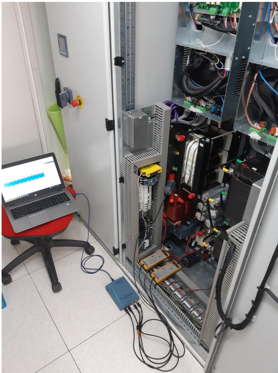
Sl. 2.2. Fotografija mjerne opreme i PWM usmjerivača tijekom snimanja valnih oblika napona i struja usmjerivača snage 100 kVA s LCL filtrom tipa A
